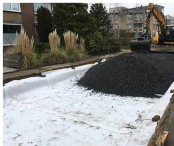
Infiltratie en tijdelijke waterberging onder de rijbaan van een straat
